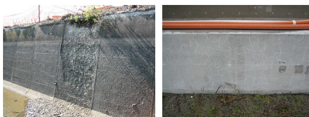
開水路側壁の断面欠損 無機系被覆材のひび割れ Fig.1 コンクリートの凍害と補修材の早期劣化 Frost damage of concrete and early deterioration of repair materials
